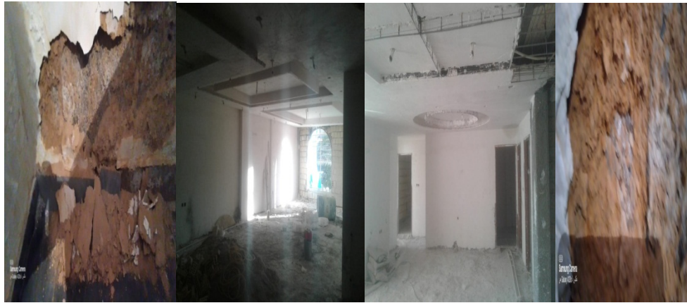
( طبله شدن گچ دیوار) ( استفاده از چسب تقویتی گچ برای سقف کناف و دیوار) (خوردگی و تبخیر آب گچ و طبله شدن)
