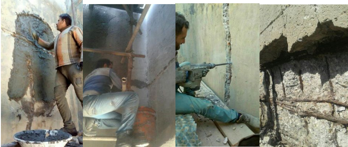
( طبله شدن بتن و اکسید شدن میلگردها) (تخریب و پرکردن ترک ها به وسیله مواد مخصوص آبتند )
