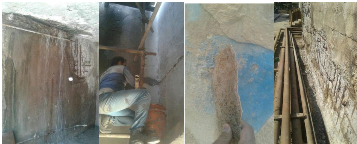
( طبله شدن بتن و اکسید شدن میلگردها (تخریب و پرکردن ترک ها به وسیله مواد مخصوص آبد) )
