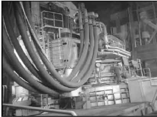
نمایی از یکی از کوره‌های بازسازی شده توسط شرکت BSL
