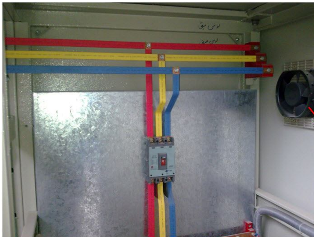
فن تهویه هوای تابلو
