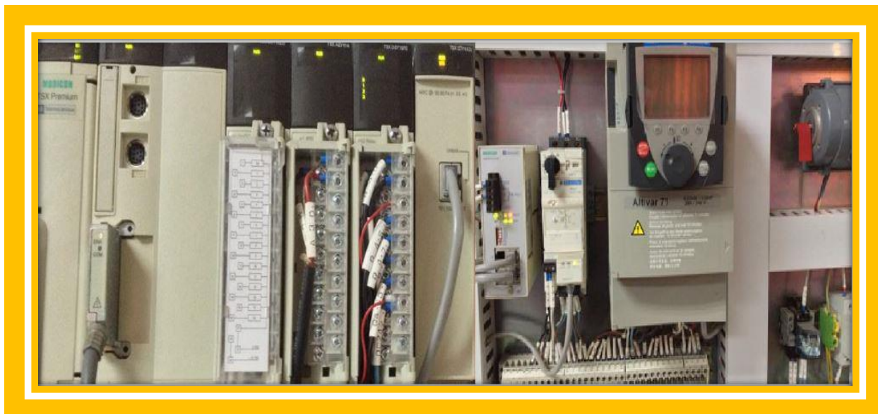
تصویر 35 Schneider Electric PLC با کنترل کننده اترنت ETY4103
