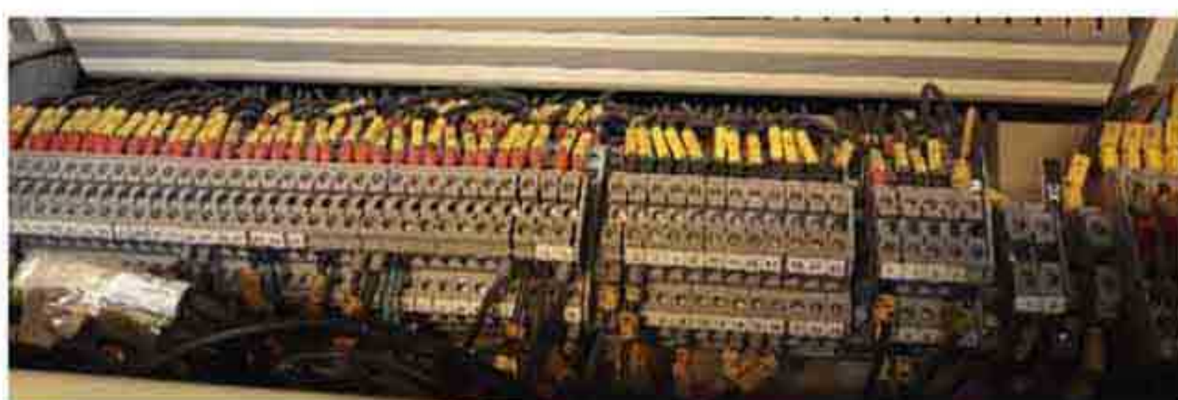
شکل ۱۱- سیگنال های تجهیزات تابلو سویچ گیر
