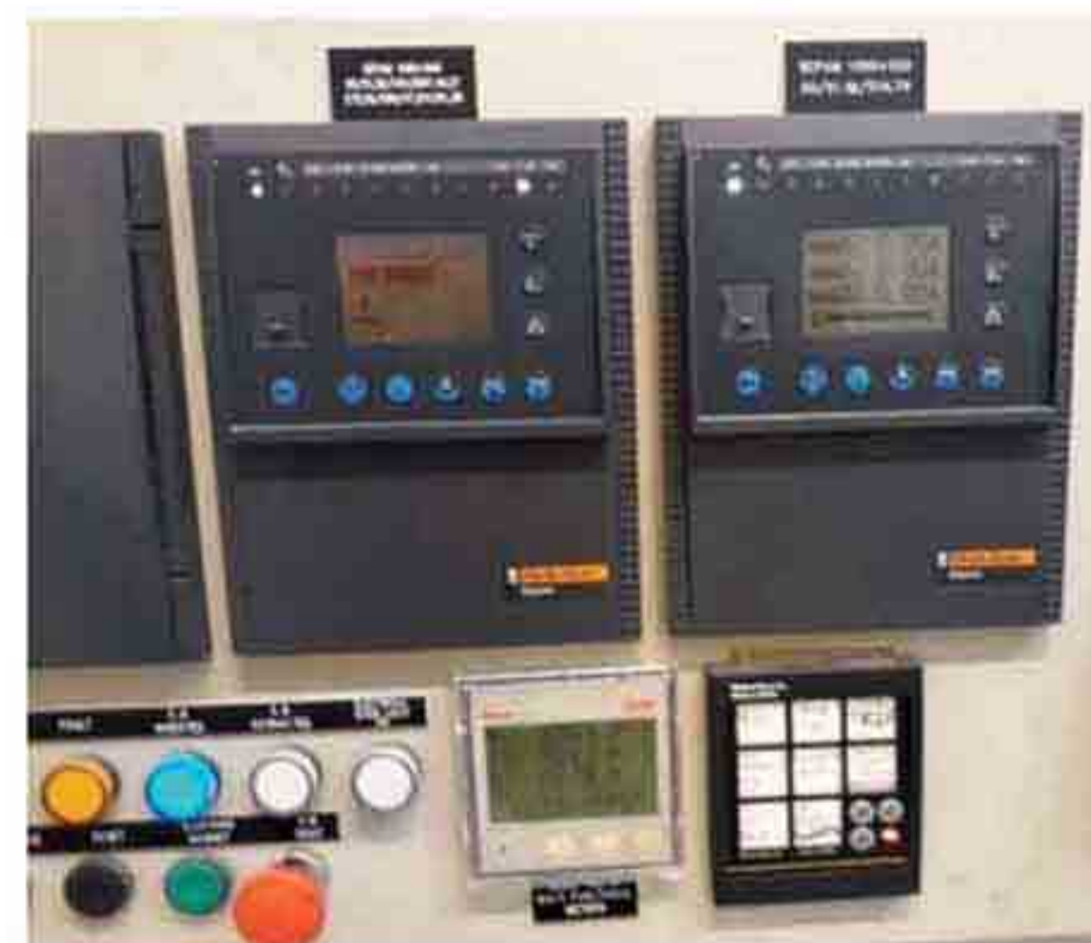
شکل ۸- رله حفاظت Schneider Electric Sepam
