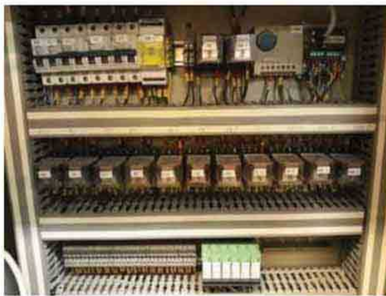
شکل ۱۳- رله‌های نصب شده در تابلو سویچ‌گیر
