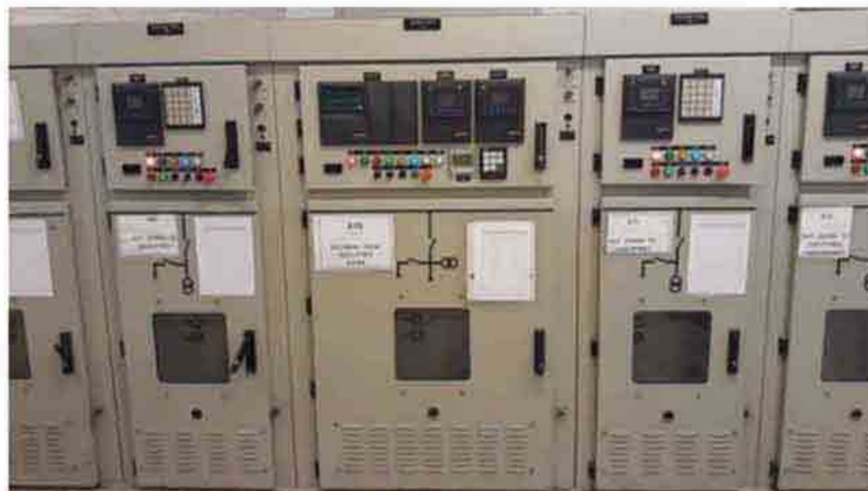
شکل ۲- تابلو سوئیچ‌گیر پست برق
