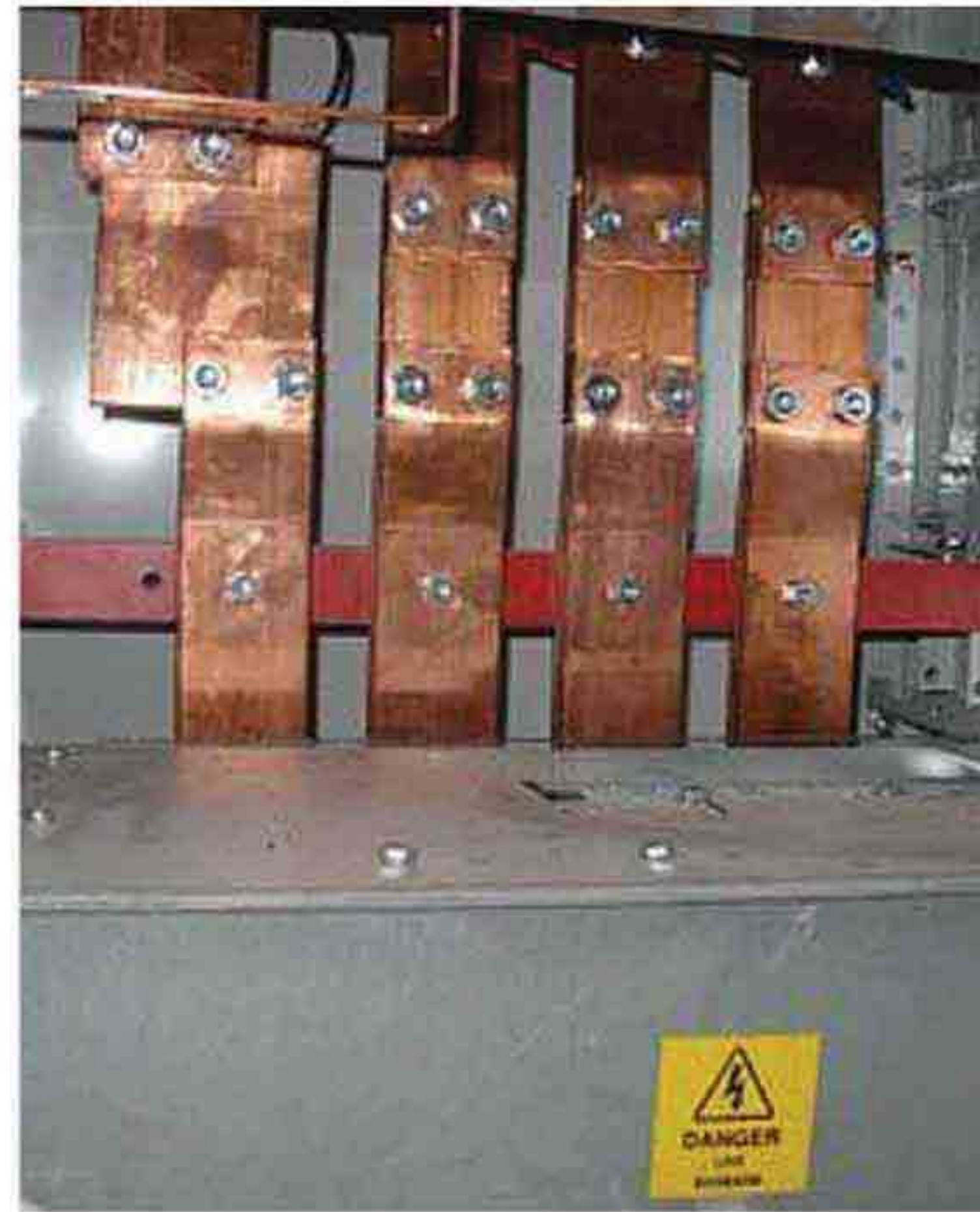
شکل ۳- شین در تابلو سویچ گیر
